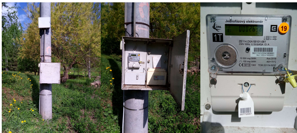
Obrázek 5: Celkový pohled, detail rozvaděče a detail elektroměru
