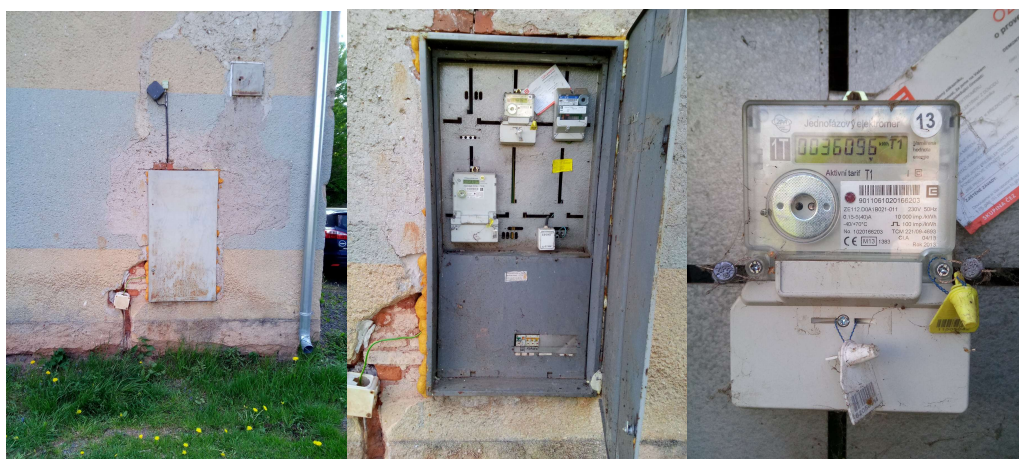
Obrázek 5: Celkový pohled, detail rozvaděče a detail elektroměru
