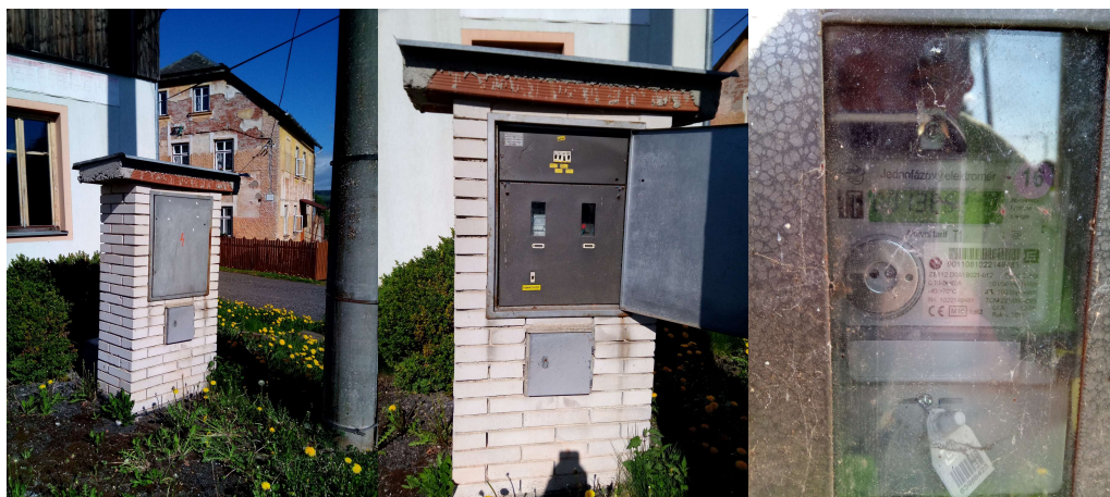
Obrázek 2: Celkový pohled, detail rozvaděče a detail elektroměru
